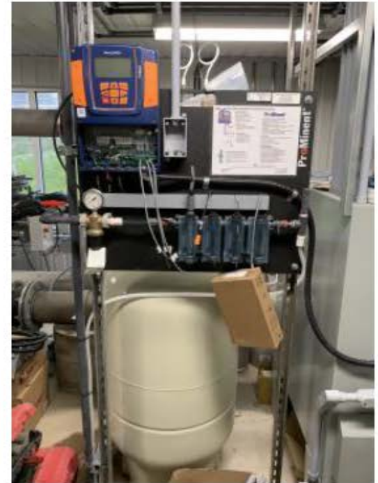
Système d'injecteur de chlore
